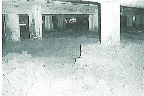
裏山が崩れ土砂が床下へ流出宇受賀地区住家
