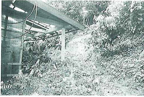
裏山の崖崩れで土砂被害を受ける宇受賀住家
